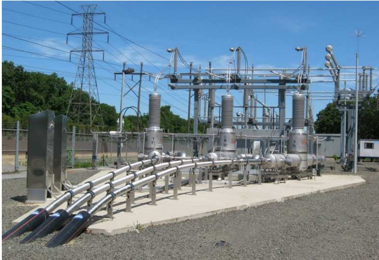
Long Island Power Authority (AmSC, Stany Zjednoczone)
